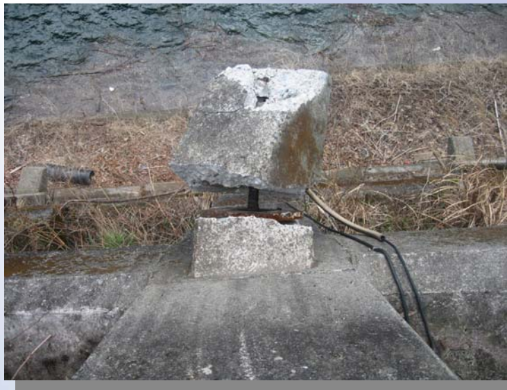
腐食による破断
