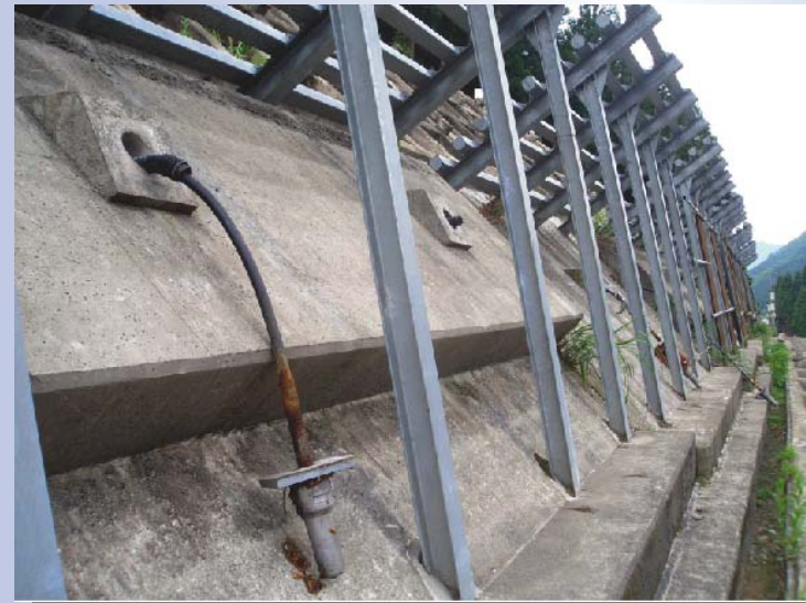
地すべり滑動による破断
